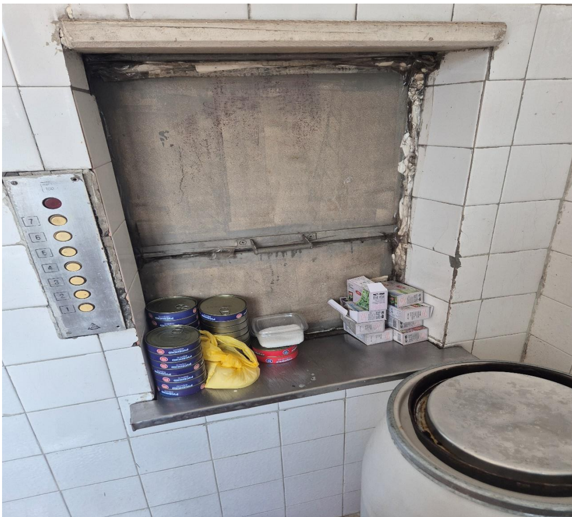
Неработещият хранителен асансьор
